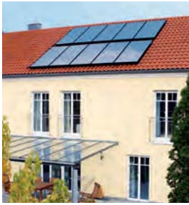
Vitosol 200-F Zweifamilienhaus Geisenfeld
